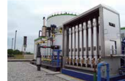
Sistema de membrana de biogás en Quasar Energy, Estados Unidos
