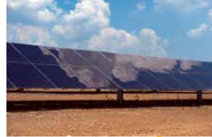
Paneles solares de células delgadas de silicio
