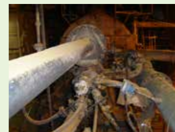
Sistema de oxígeno renovado obra de los ingenieros de Air Products.
